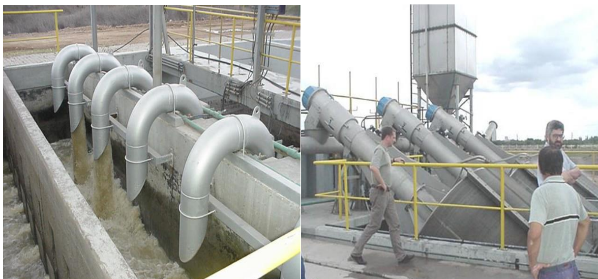
Figura 25 – Sistema de rejas y pozo de bombeo Depuradora Bahía Blanca (ABSA, 2010)
