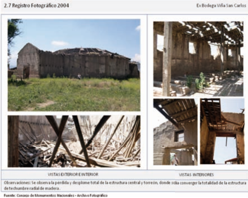
Fig. 4 Imágenes de la bodega con la pérdida total de su techumbre.
