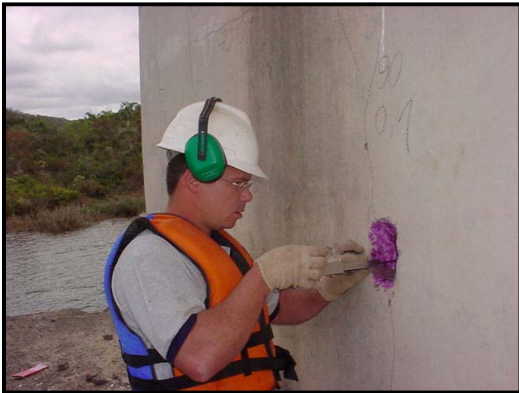
Figura 10: Utilização da técnica de ensaio não-destrutivo na base de líquido penetrante em pilar de ponte sobre a represa de Peti, Minas Gerais, Brasil.
