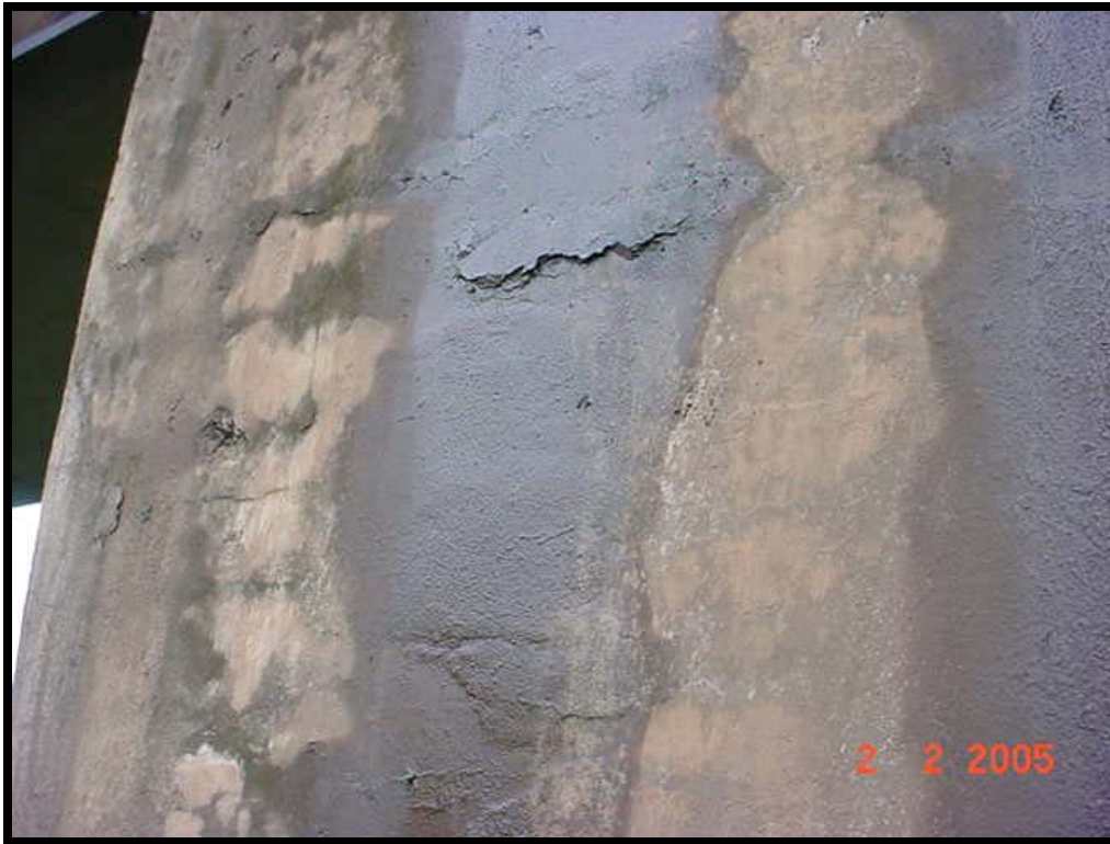
Figura 6 – Fissuras em pilar de concreto armado de ponte sobre o Córrego do Ouro, Minas Gerais, Brasil.
