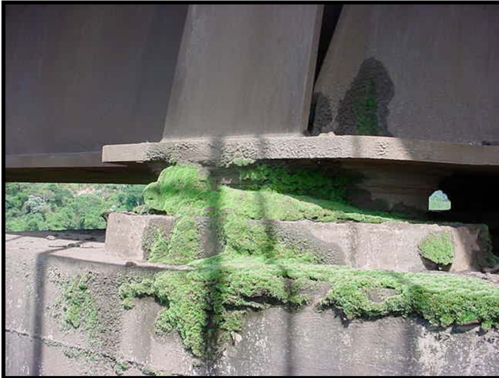
Figura 5 – Briófitas em aparelho de apoio de ponte sobre o Córrego do Ouro, MG, Brasil.
