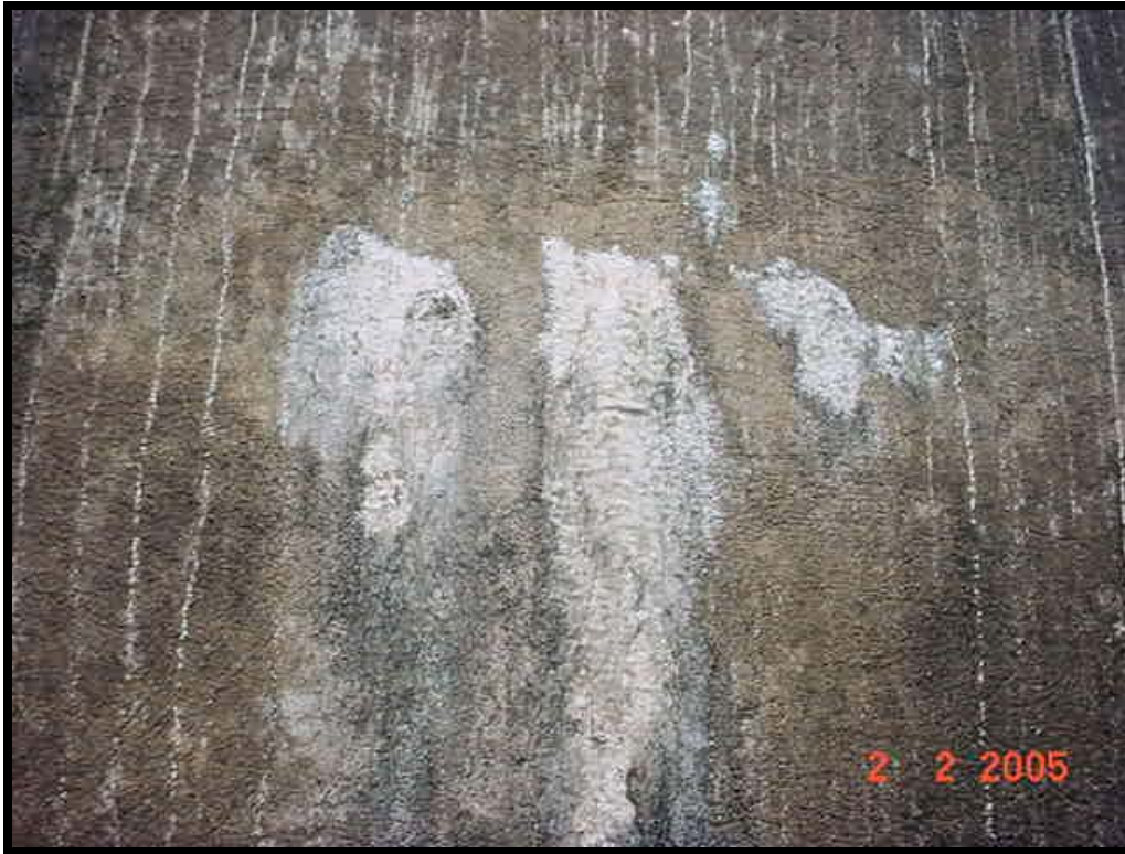
Figura 4: Pilar de concreto armado sob o efeito da carbonatação, da Ponte sobre o córrego do Ouro, em Minas Gerais, Brasil.
