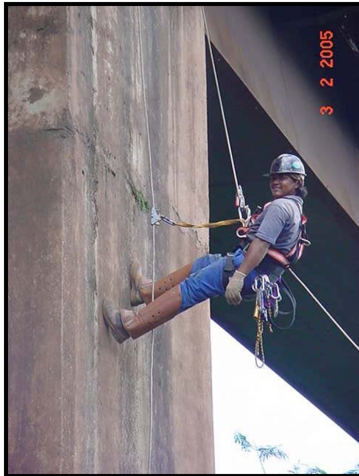
Figura 8 – Análise visual das anomalias de ponte em ambiente nativo no interior de Minas Gerais, Brasil, com a presença de briófitas nas fissuras do concreto armado do pilar.
