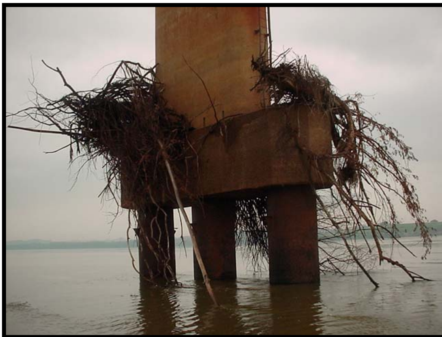
Figura 11: Vegetação (juncos) sobre o bloco de coroamento de ponte no rio Tocantins, Pará, Brasil.
