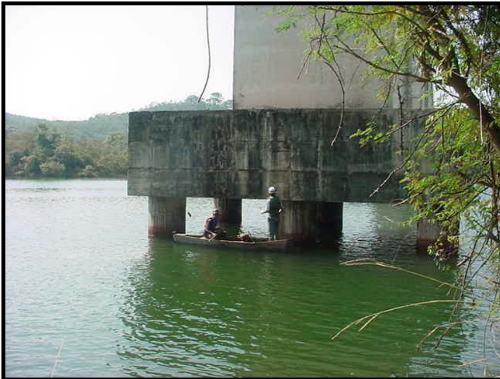
Figura 9: Inspeção visual de infra-estrutura de ponte situada sobre a represa de Peti, ambiente nativo, em Minas Gerais.
