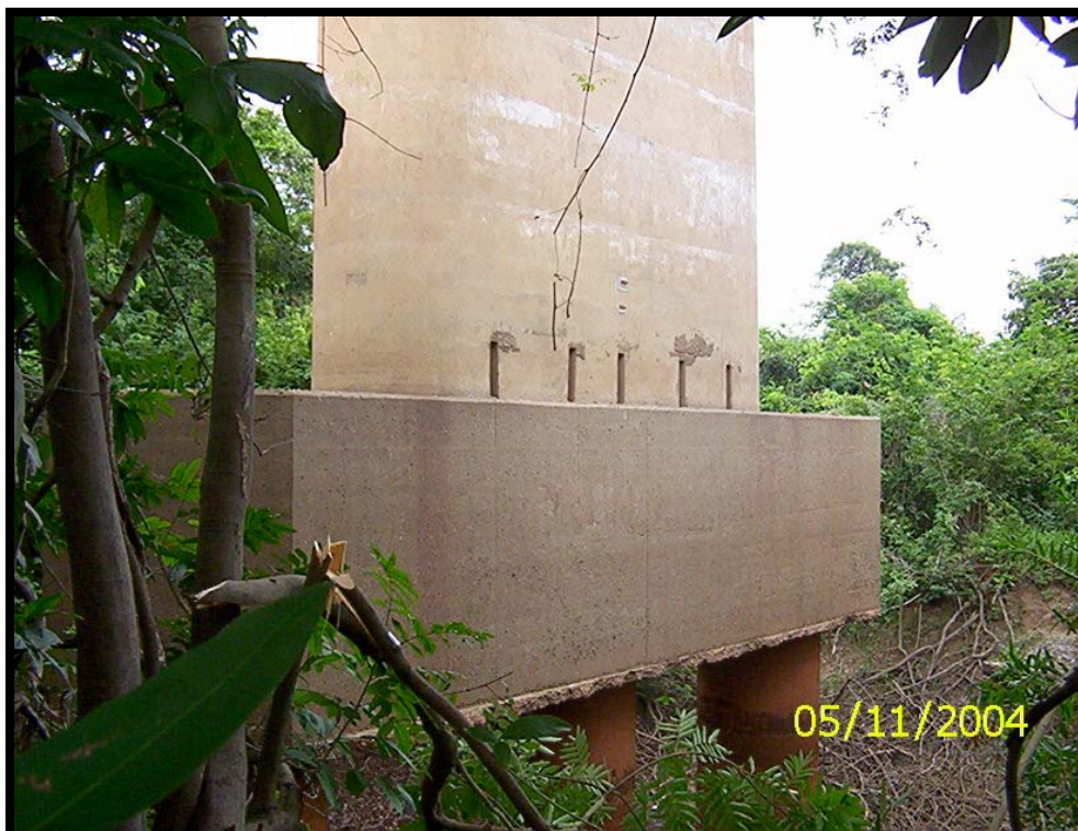
Figura 3: Corrosão em estrutura metálica dos tubulões da Ponte do rio Tocantins, no Pará, Brasil.
